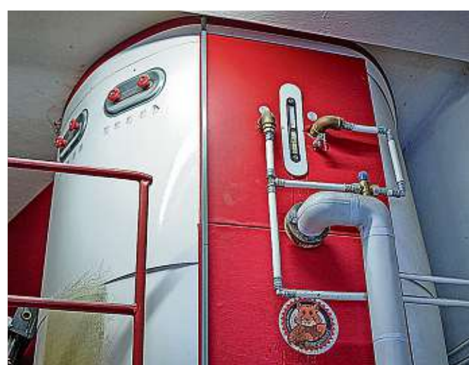
Mit diesen großen Tanks wird die gewonnene Wärme sozusagen „gehamstert“.
